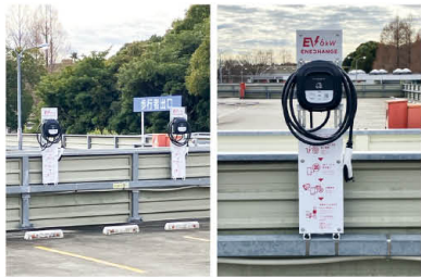
EV用普通充電器は、金沢動物園の正 面口駐車場に設置されている。
